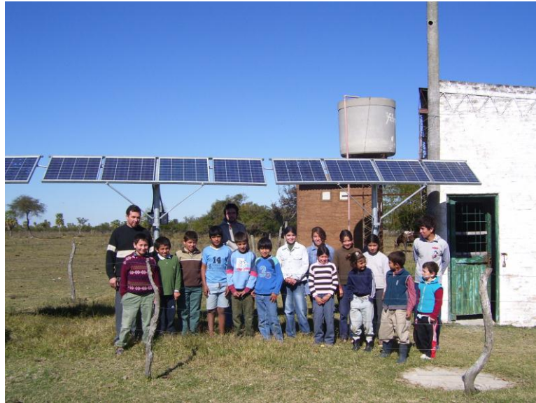
Figura 1.- Sistema fotovoltaico de 600Wp instalado en la escuela n° 223 Paraje San Lorencito – dpt. de Empedrado – prov. de Corrientes, Argentina, junto con el maestro y los alumnos de dicha escuela.
