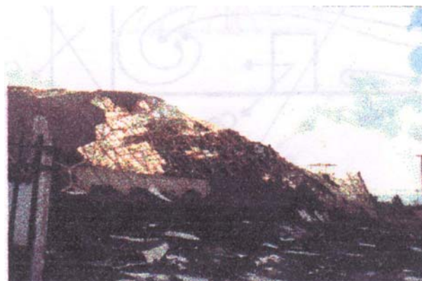
Foto 13.8 – Sector de la estructura vista desde el acceso al anfiteatro – Placas de hormigón que formaban la cubierta. Solamente algunas permanecen sobre la estructura, el resto fue diseminado sobre el terreno circundante.
