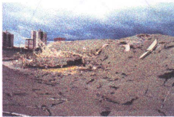
Foto. 13.9 – Vista aérea de la cubierta desplomada sobre el escenario.
