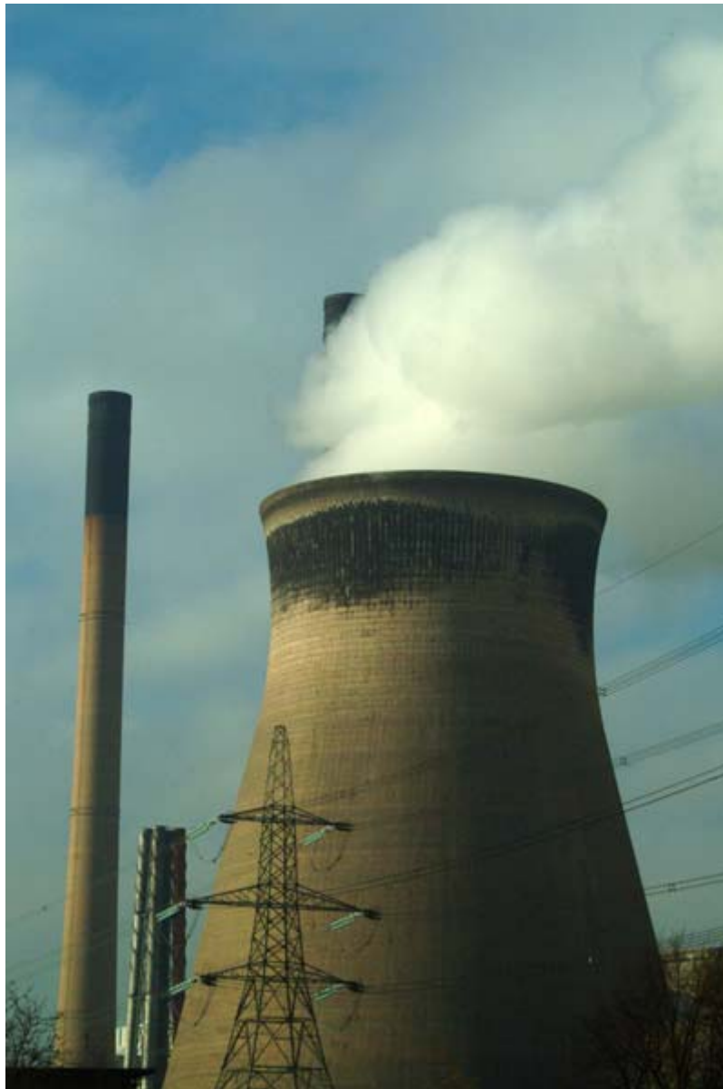
Foto 13.15.-Daño exterior del revestimiento por carbonatación de la superficie incrementado por la acción del viento (Construido en 1950)
